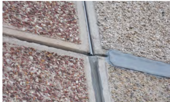
Abb. 2: In diesem Fugenspalt fand sich bei der Kontrolle Fledermauskot einer kleinen Art
