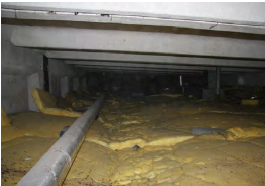
Abb. 3: Blick in einen Dachboden, vorn links im Bild auf der Dämmung Fledermauskot unterhalb eines Quartiers in einer Dachplattenfuge
